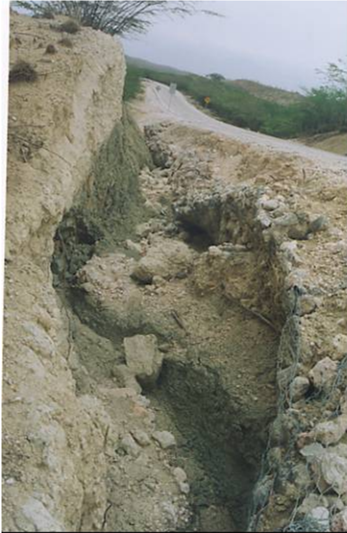
Fuerte erosión junto a la carretera Duvergé Jimaní.
